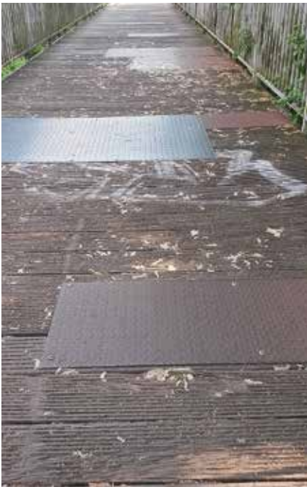
vor der Sanierung: Metallflicken soweit das Auge reicht
