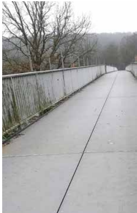
im Februar 2019 sind zwar die Metallplatten installiert, doch die rutschhemmende Beschichtung fehlt noch
